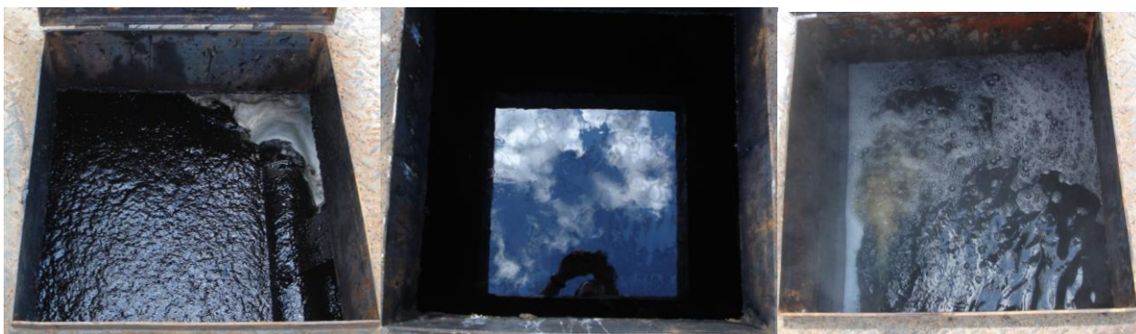
а) процесс всплытия СНО б) отстойная ёмкость в) ёмкость с чистым раствором Рисунок 4 – Технологические люки ёмкостей отстоя модульной промывочной установки
